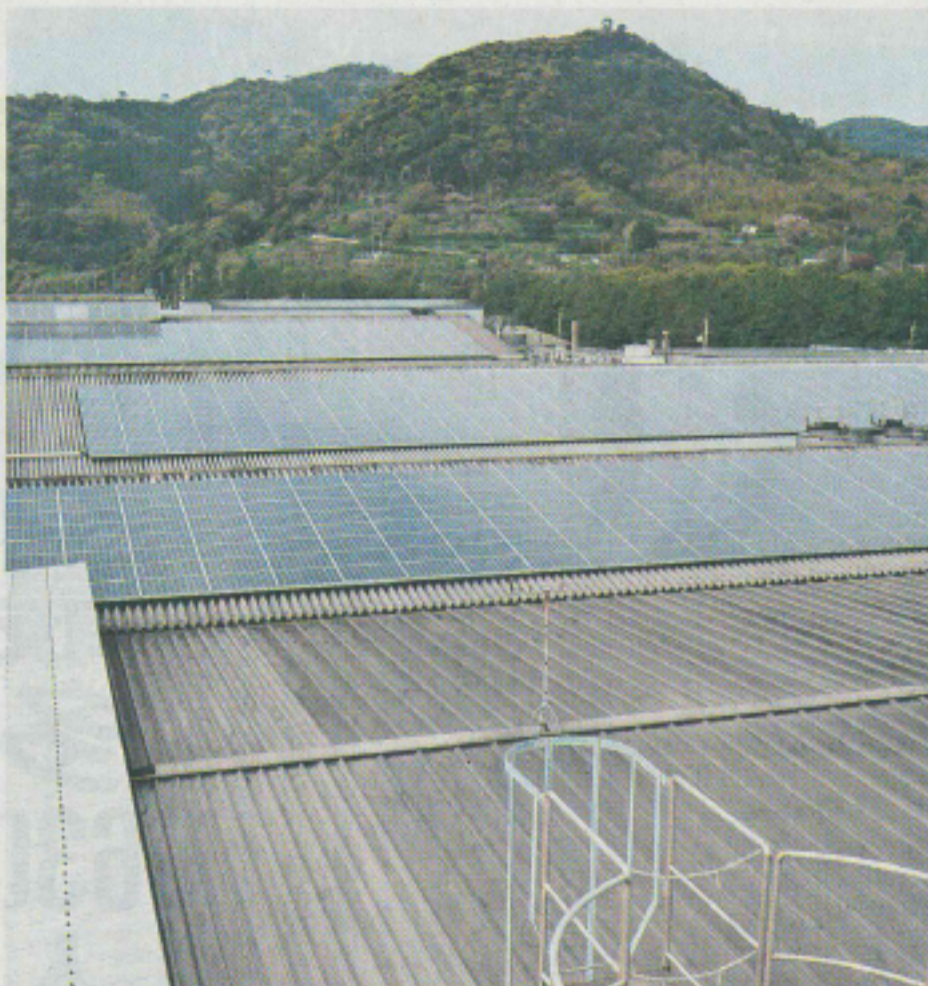
焼酎工場の屋根に設置された太陽光発電設備
